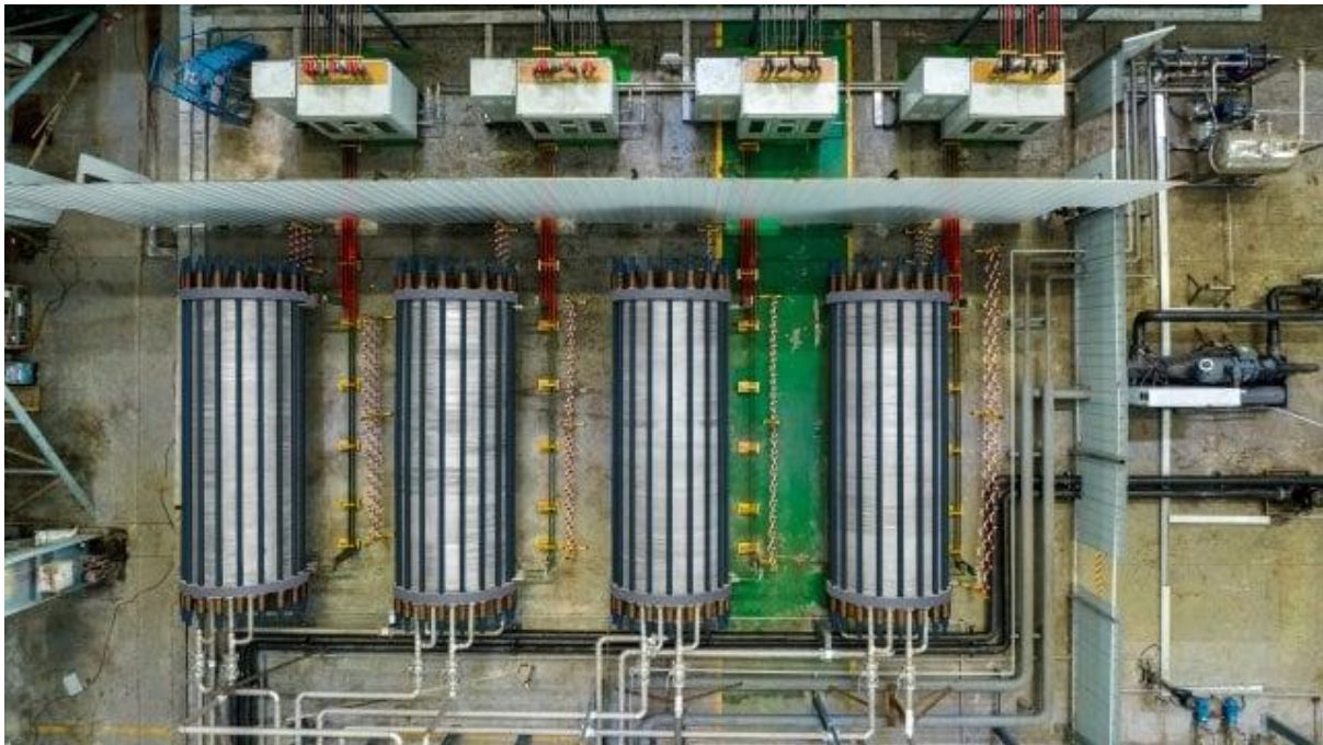
Un électrolyseur à hydrogène vert de John Cockerill, en Inde. ©John Cockerill
